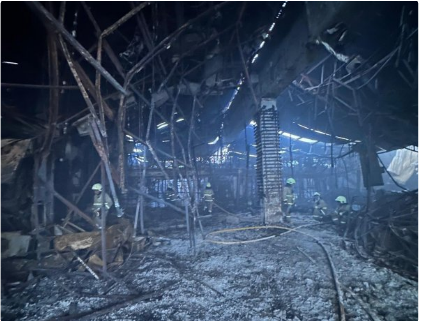
Glodok Plaza yang Hangus Terbakar
